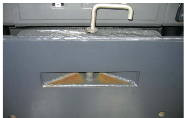
Hiontapölyn aiheuttamaa korroosiota asennuslevyllä
