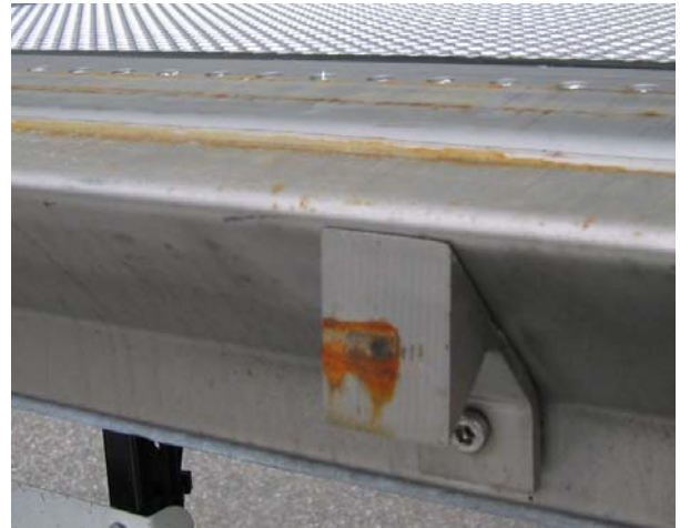
Korroosiota kuljetuskorin pohjarunkoprofiilissa
