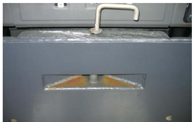
Hiontapölyn aiheuttamaa korroosiota asennuslevyllä
