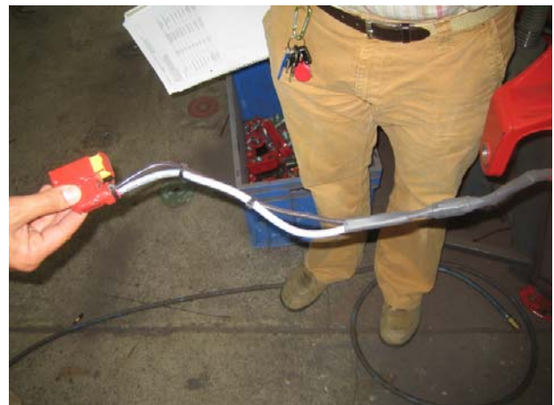
CAN 4-napainen kierretty johto akselimodulaattorille, jatkettu välipistokkeen avulla
