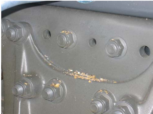
Porauslastuja auton rungossa
